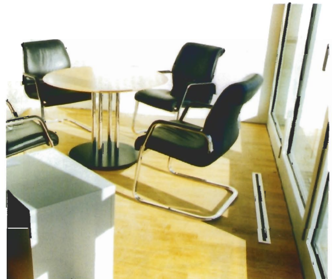
Detail Büro: Luftauslass-Schlitzschiene
